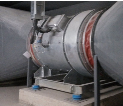
a) 在混凝土基础上安装的卧式 Horizontal on concrete foundation
